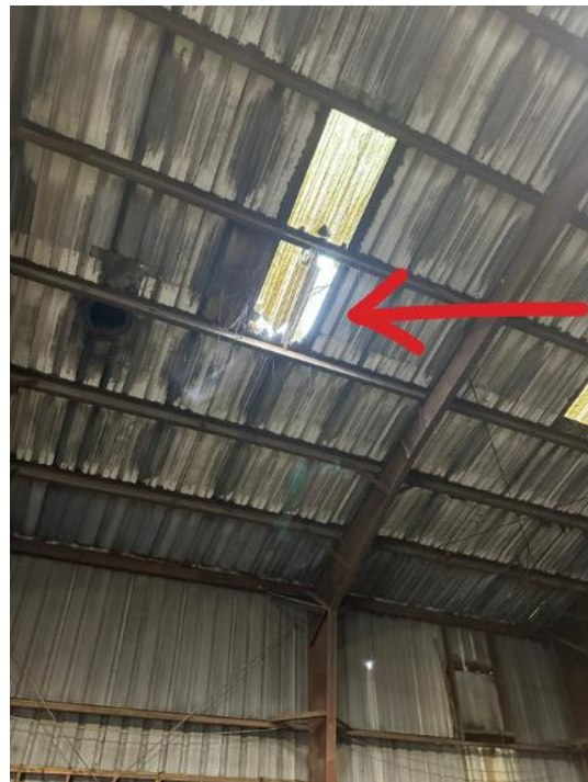
Foto 5. La flecha roja indica el tragaluz de policarbonato ya roto.
