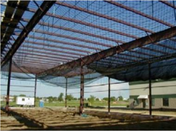
Foto 8. Sistema de red de seguridad. [OSHA, 2015]
