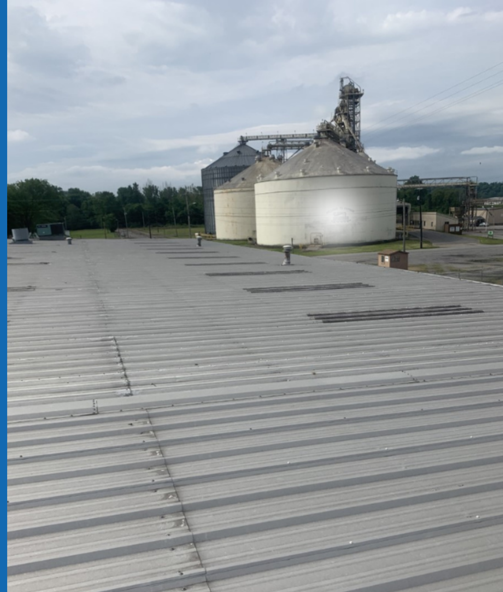
Foto que muestra el techo metálico con los tragaluces de fibra de vidrio donde se produjo el incidente.
